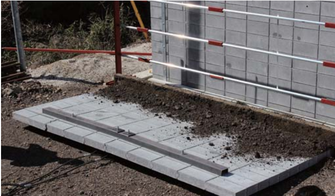
● 耐震補強前のブロック塀 牽引荷重約4kNで瞬間的に基礎ごと転倒 予想通りの脆弱さを再確認
