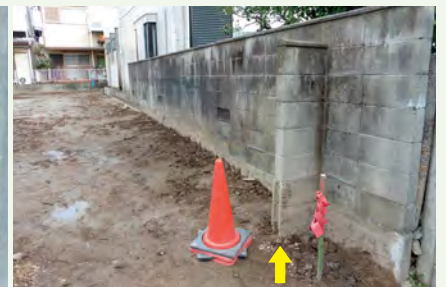
既設CB塀には控え壁が1箇所のみ
